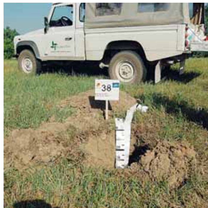
Due immagini dei lavori in corso per riconvertire l'area dell'ex discarica di Borgotrebbia in un parco urbano e terreni coltivabili (foto Novara)
